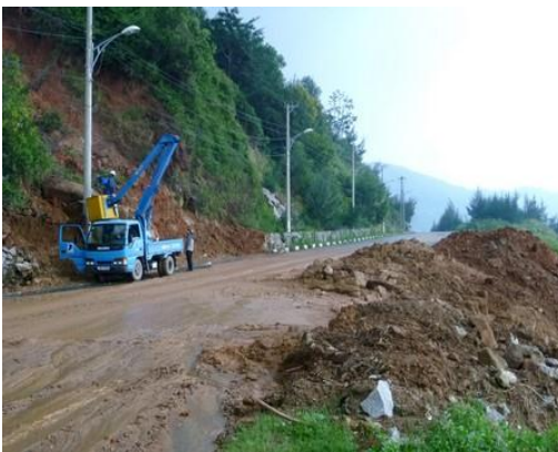
Sạt lở đường (BDST)
